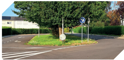
Villagexpo : rénovation des avenues principales et des trottoirs et mise en zone 30km/h.
