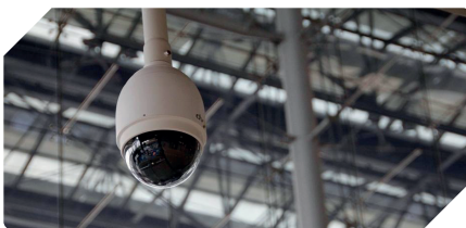
Extension du réseau de caméras de surveillance sur le territoire (plus de 50 caméras installées).
